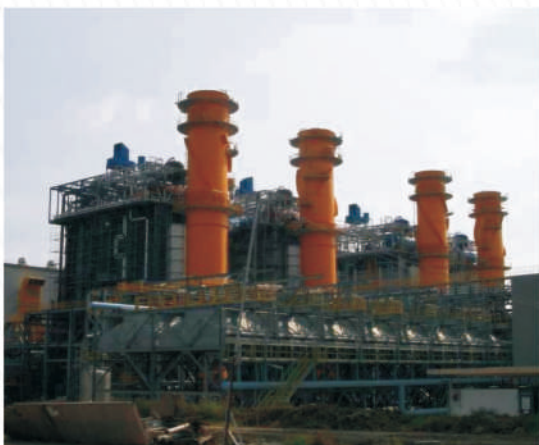
森霸發電廠 Sanba Power Co., Ltd.
