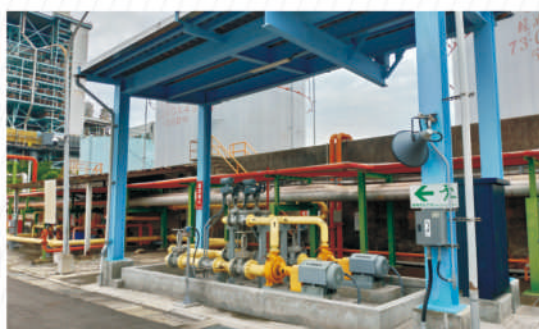
大林電廠 Ta Lin Power Company
